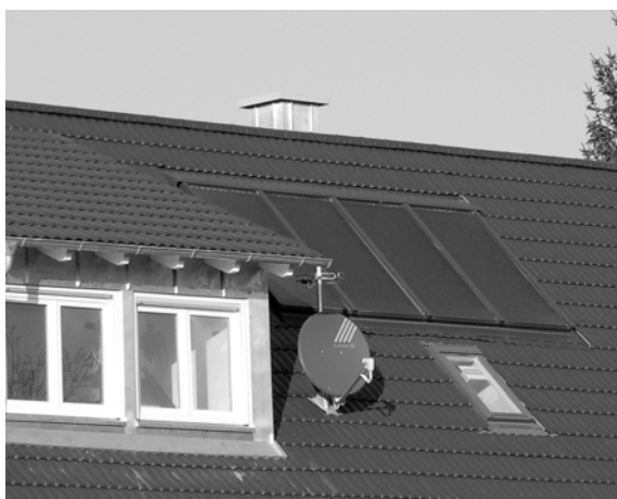
Abbildung 2.8: Dachintegrierter flüssigkeitsbasierter Flachkollektor integriert in ein Satteldach
