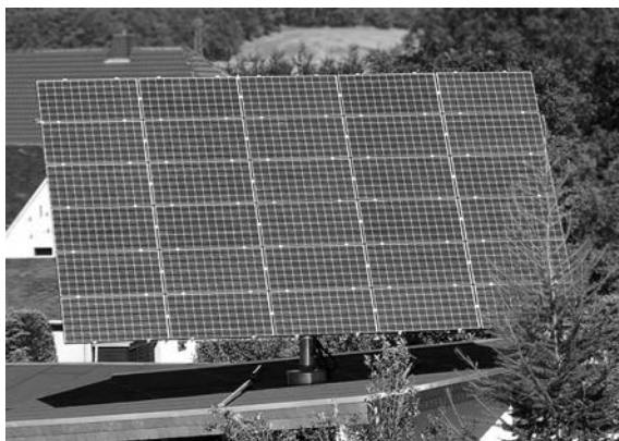
Abbildung 2.5: Nachgeführte Fotovoltaikanlage auf einem Pultdach
